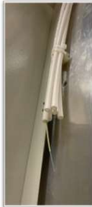
7/4er Leerröhrchen im Keller
