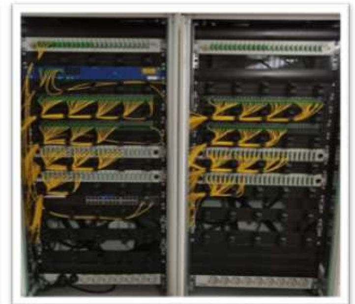
Zentrale im Kellerraum (64 WE pro Schrank)
