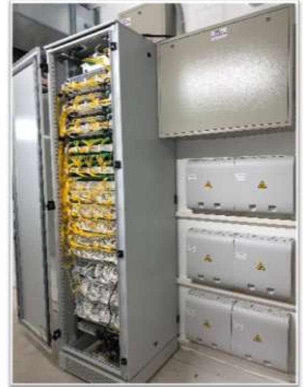
Kellerraum von einem Gebäude mit rund 100 angeschlossenen Wohneinheiten
